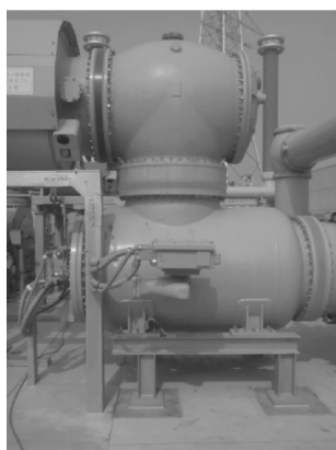
图10 济南现场隔离开关图片
